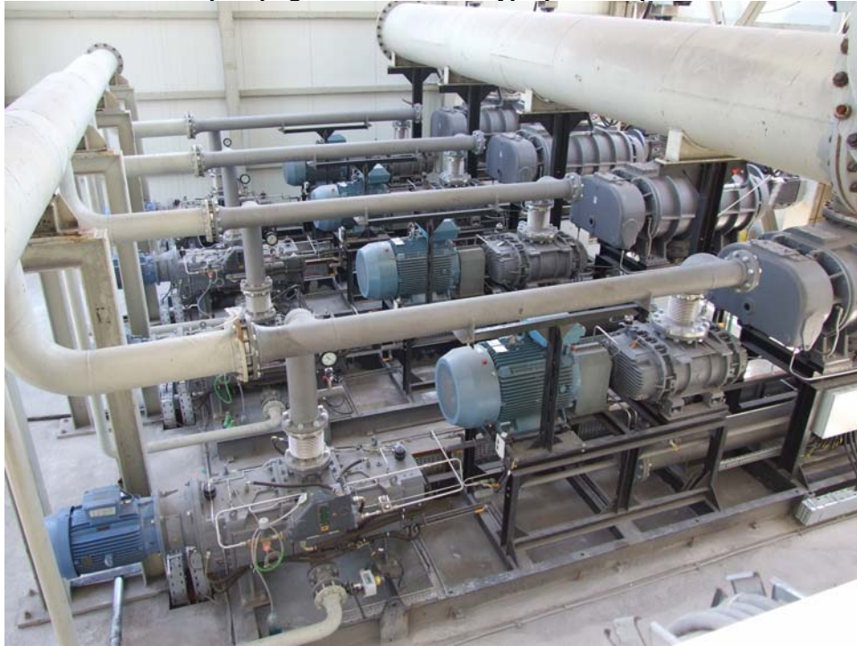
Figure 1 Installation de pompage sec modulaire type pour un procédé VD de 90 tonnes
